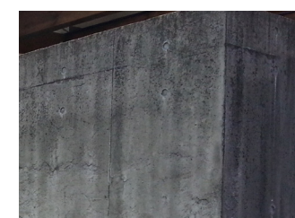
経年劣化・黒ずみ
