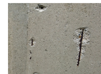
剥落・鉄筋露出
