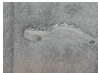
クラックピンホール
