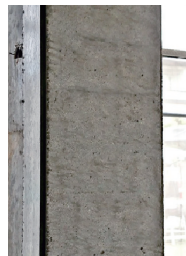
施工前（表面剥離）
